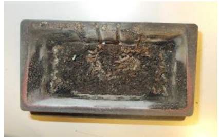
BEISPIEL VERSCHMUTZTE BRENNSCHALE
