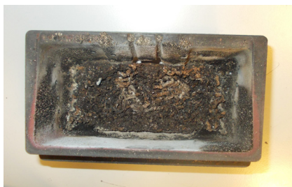
BEISPIEL VERSCHMUTZTE BRENNSCHALE
