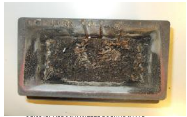
BEISPIEL VERSCHMUTZTE BRENNSCHALE
